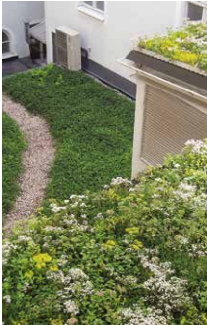
Grøn indergård med Veg Techs opbygning og plantemateriale.
